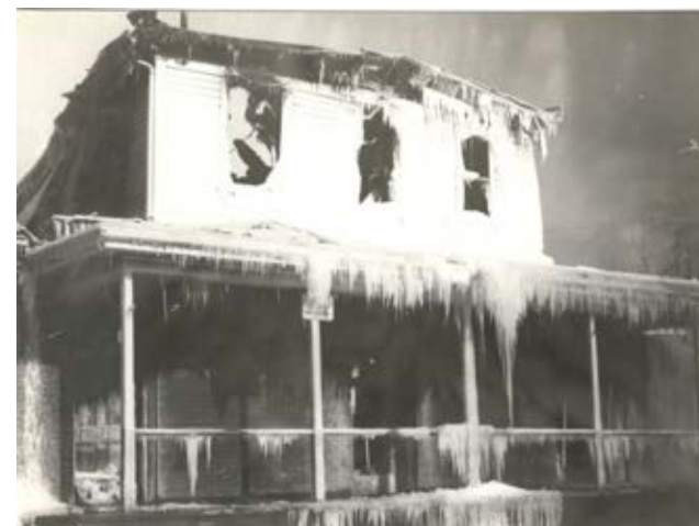
A sede da Associação Beneficente D. Luís Filipe em Bristol que foi destruída por um incêndio em 1983.
